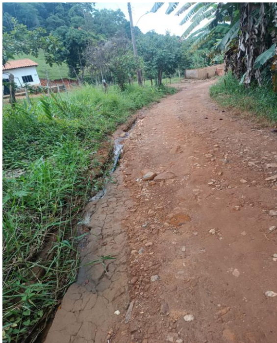
Pontas de pedras e buraco por toda via.
