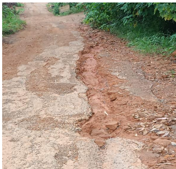
Buracos e erosões na estrada.
