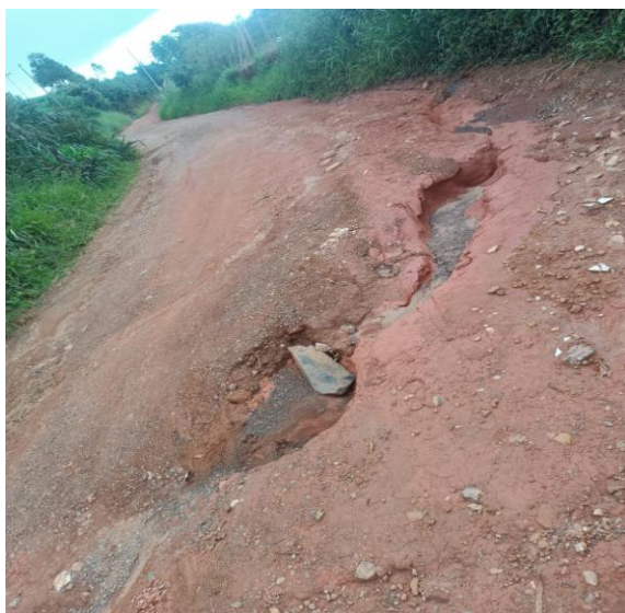
Buracos e erosões na estrada.
