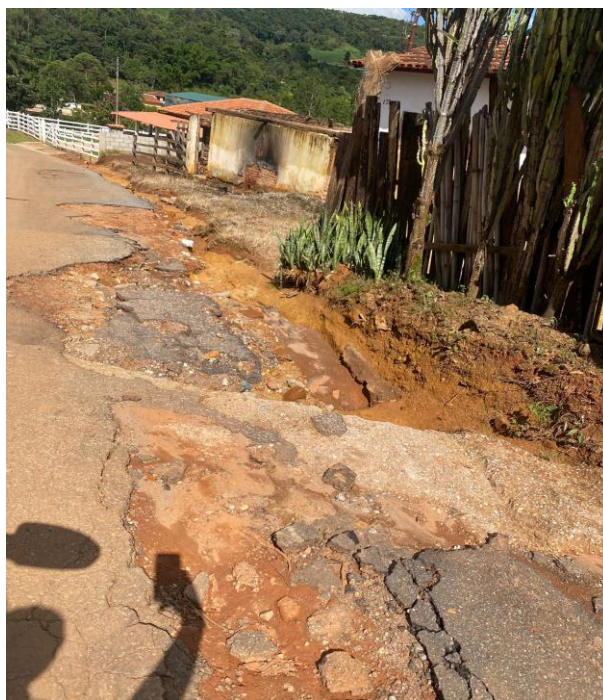
Buracos e erosões na estrada.
